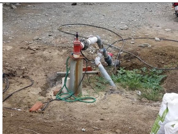
Foto 4. Captación de agua subterránea
