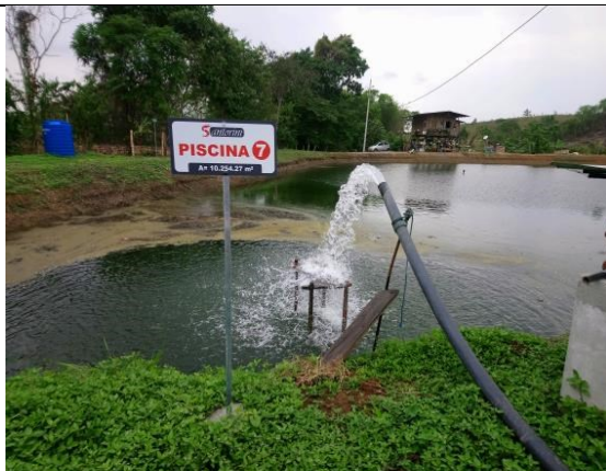
Foto 9. Pozo en camaronera
